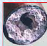
Rura wodociągowa z kamieniem osadowym
